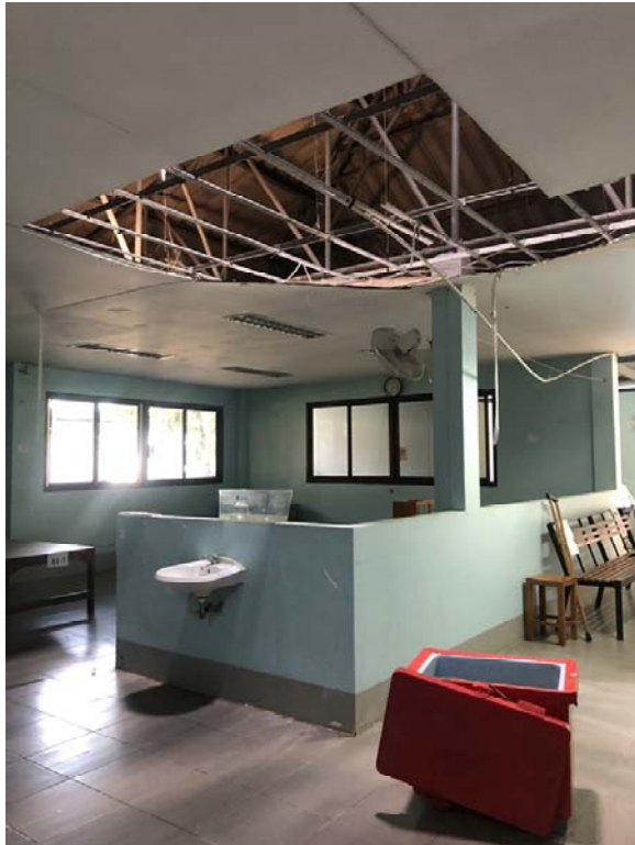
写真左 天井の落ちた外科病棟
